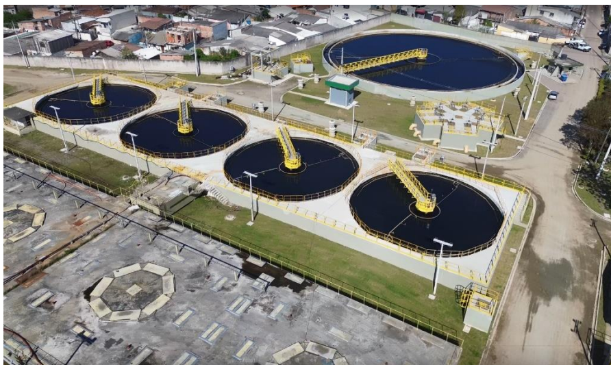
FIGURA 24 - DECANTADORES - ESTAÇÃO DE TRATAMENTO DE ESGOTO ATUBA SUL
