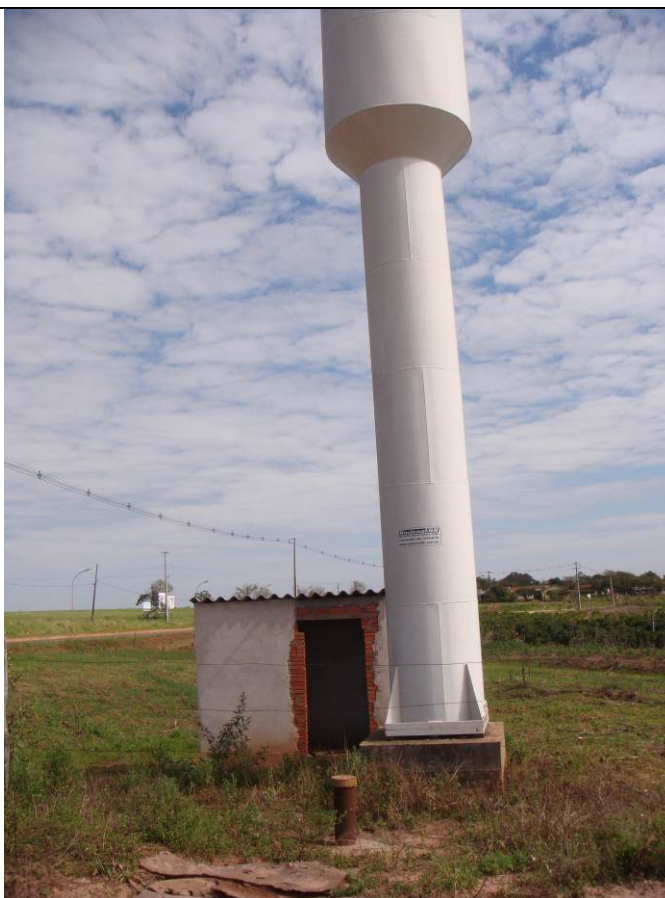
Fotografia nº 10 – Sistema de abastecimento de água inoperante na data da visita – Localidade Andorinha, Município de Araruna – Data: 10/08/2015.
