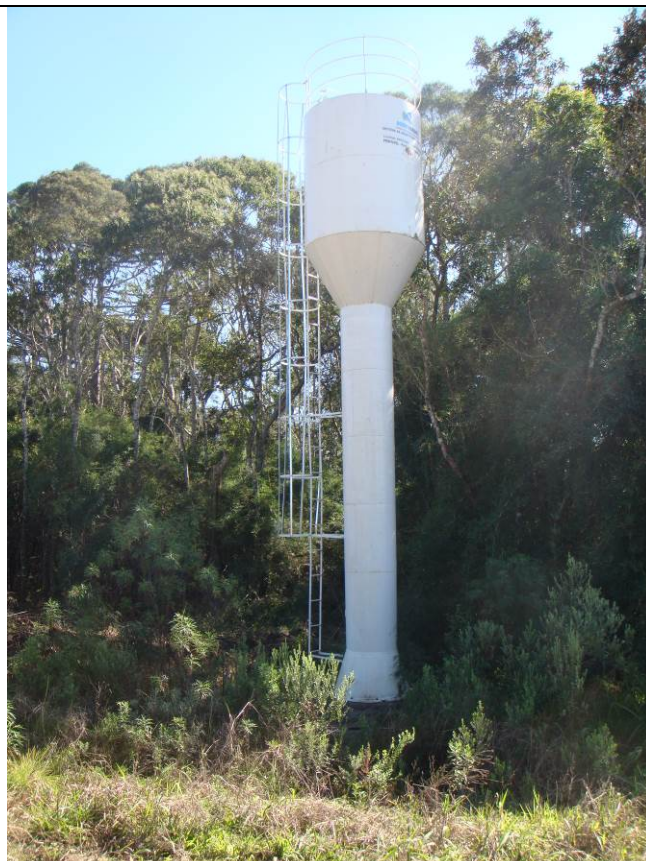
Fotografia nº 13 – Sistema de abastecimento de água inoperante na data da visita – Comunidade Segunda Linha Marcondes, Município de Prudentópolis – Data: 10/08/2015.
