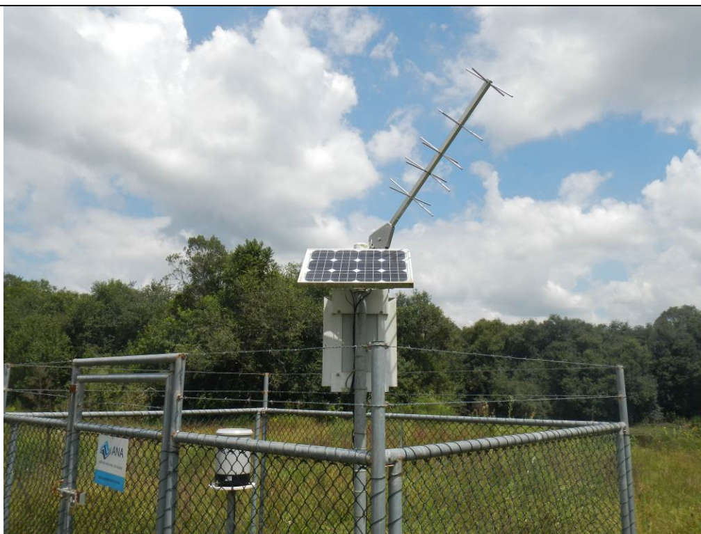
Fotografia nº 08 – Estação Telemétrica no Rio Iguaçu – Município de Guajuvira – Data: 04/03/2015.
