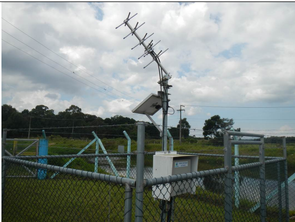
Fotografia nº 07 – Estação Telemétrica – GPRS Sanepar Canal Paralelo ao Rio Iguaçu – Data: 05/03/2015.
