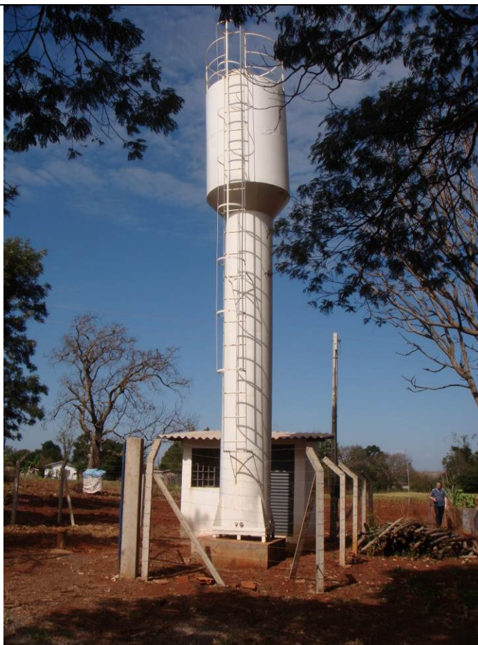
Fotografia nº 12 – Sistema de abastecimento de água inoperante na data da visita– Comunidade de Pensamento, Município de Mamborê – Data: 10/08/2015.
