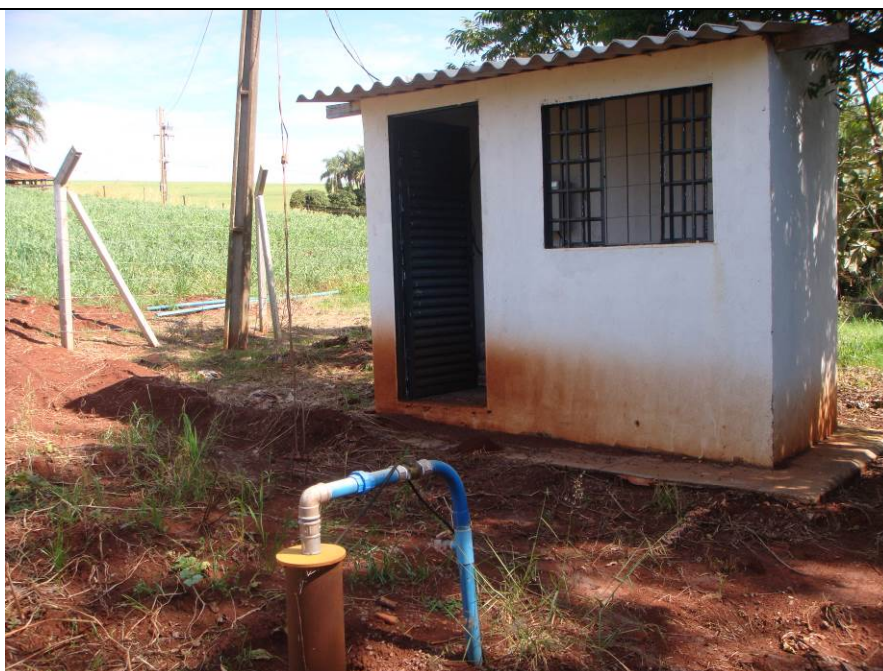
Fotografia nº 11 – Sistema de abastecimento de água inoperante na data da visita – Localidade Estrela D’Alva, Município de Boa Esperança – Data: 10/08/2015.
