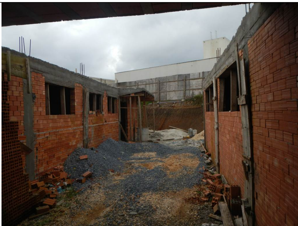
Fotografia nº 06 – Obra de Unidade de Saúde no Município de Itaperuçu que se encontrava paralisada na data da visita – Data: 29/04/2015.
